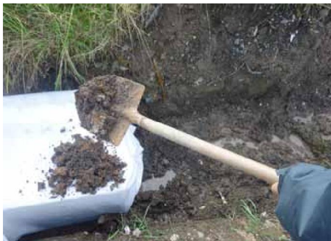
9 Jámu zasypejte původní zeminou hutněnou po vrstvách. Pokud se po zasypané jámě bude chodit, tloušťka vrstvy zeminy je min. 20 cm, pro pojezd aut 60–80 cm a nákladních aut 1 m
