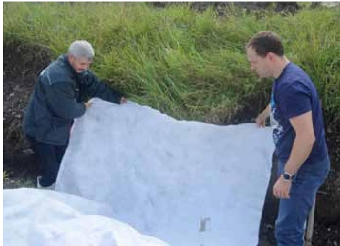
5 Na dno a boky výkopu rozprostřete geotextilii (200 g/m 2 ) k obalení vsakovacích bloků. Bloky lze zabalit i předem vedle jámy
